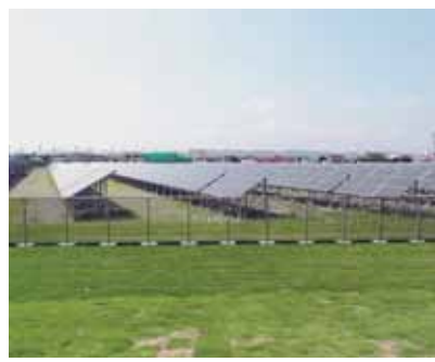
北陸電力太陽光発電所(婦中町上轡田)
